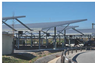
Parking de stationnement avec ombrières photovoltaïques
