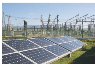
Centrales au sol
